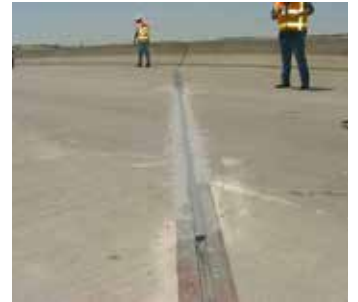
翻新后的接缝
